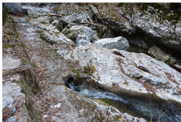
Figura 12 - scarico opera di presa acquedotto di Trasaghis
